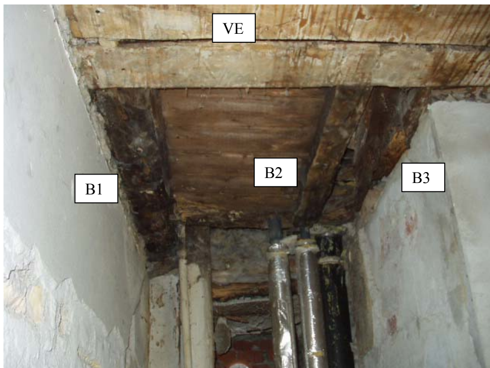
Foto 1: Der kunne konstateres kraftig nedbrydning i bjælker mv.
