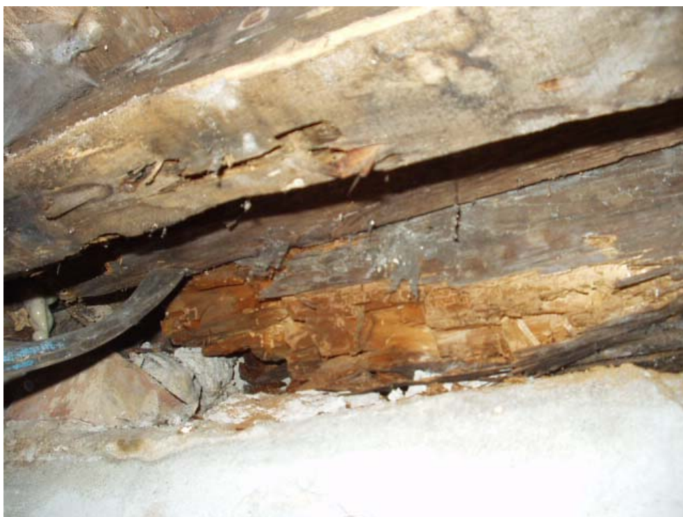
Foto 2: Bjælke B3 over mur.
